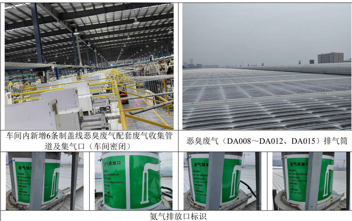
图 3-3 废气治理措施现场照片
